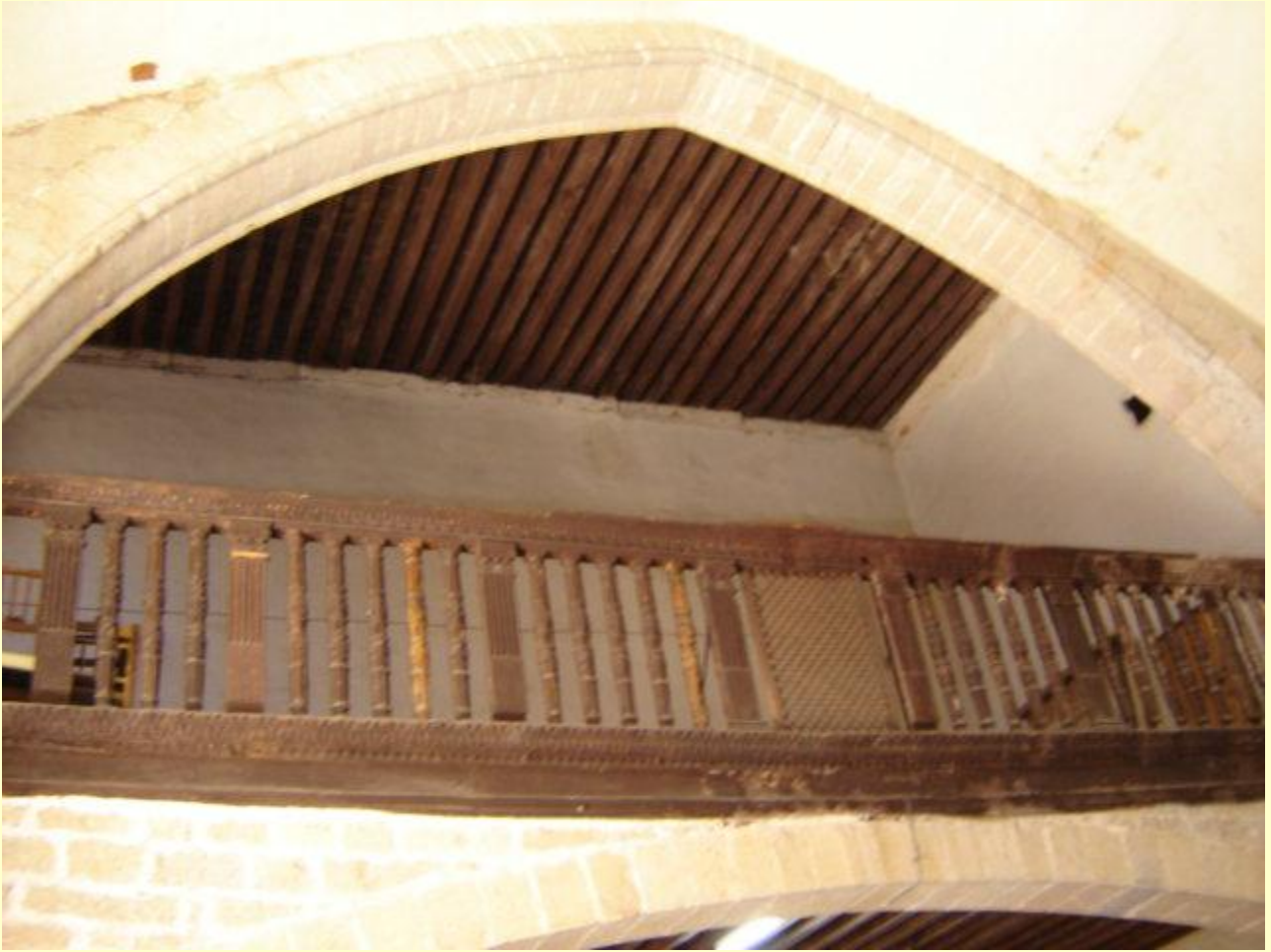
La sillería del coro nuevo necesita de una urgente restauración
