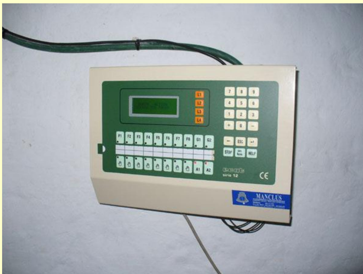
Modern quadre de comandament dels tocs de les campanes en la sagristia
