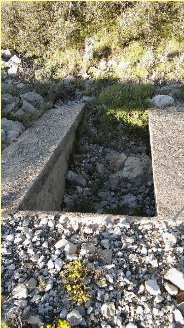
Conductes de desaigüe de l'aigua d'escorrentia d'eixida.
