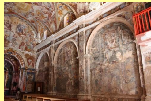
Pintures de les capelles de la dreta en mal estat per la humitat. Dalt del Cor, Sant Antoni
